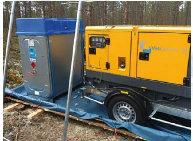
Kalajoen Kurikkalan koevesipumppauksissa käytettiin siirrettävää varavoimakonetta.
